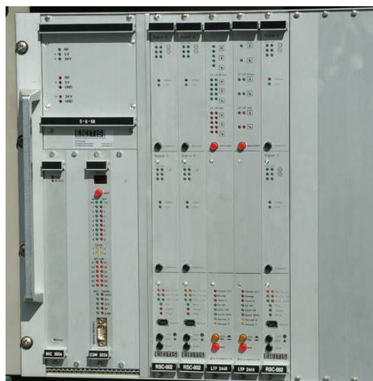
Streckenstation mit drei neuen RSC-002 Signalsteuerkarten und zwei älteren LTP Leistungskarten
